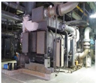
改善前：吸収式冷凍機セット
