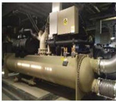
改善後：超高効のターボ冷凍機セット
